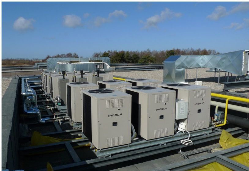
Rys.10. Instalacja gazowych absorpcyjnych pomp ciepła w Słupskim Inkubatorze Technologicznym [4]
